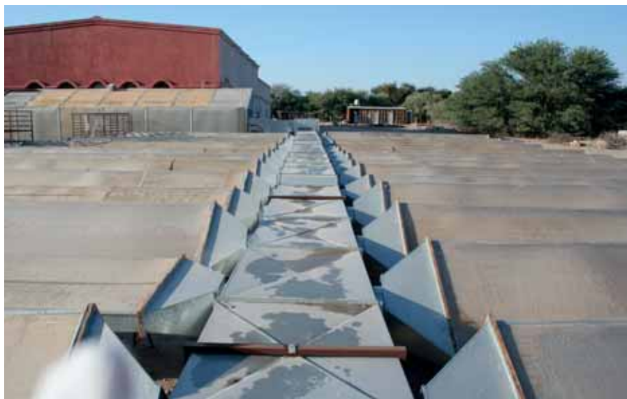
A napenergiával működő szárító hőkollektorai
